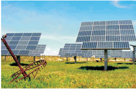
Figura 2 - Conjunto de painéis solares
