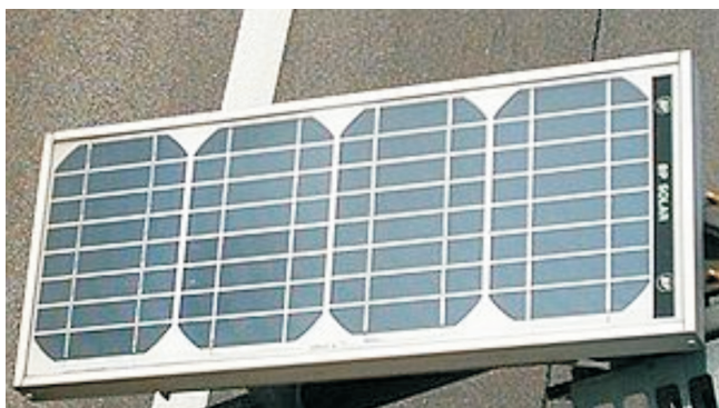
Figura 4 – Painel solar fotovoltaico
