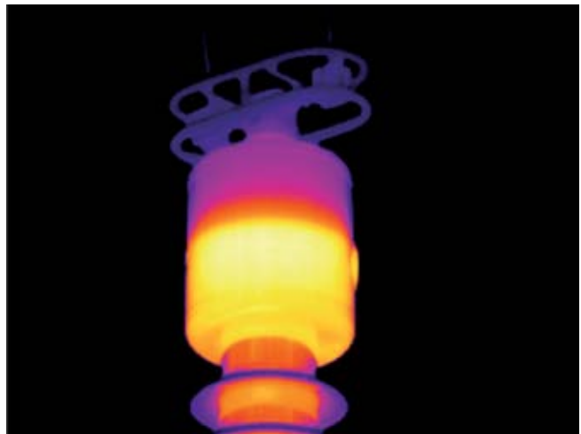
Figura 2 – Termograma de um Transformador de Potencial e a visualização do nível de óleo
