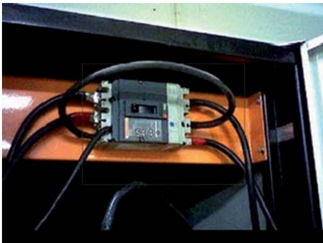
Figura 5 - Disjuntor visto a olho "nu" Fonte: TERMOGRAFIA BRASIL, 2010
