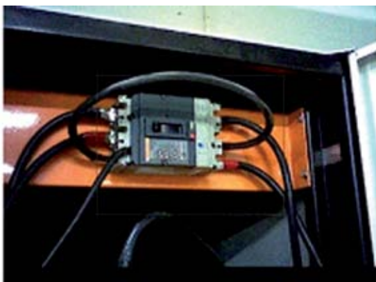
Figura 1 - Disjuntor a olho nu aparentemente em estado normal de funcionamento
