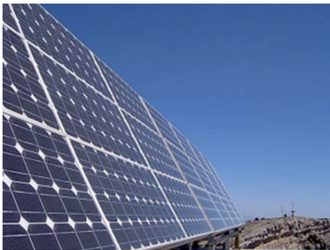
Figura 1 – Painéis de energia solar
