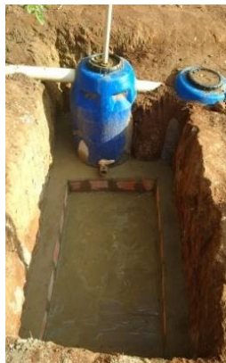
Figura 24. Leito de secagem do lodo
