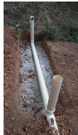
Figura 18. Manutenção da condição aeróbia: Tubos de exaustão
