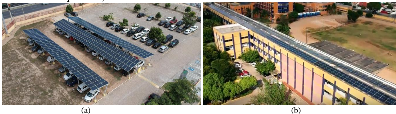
Figuras 2. Estacionamento coberto por sistema de ESFV-CR no campus Parnamirim (a) e Sistema de ESFV-CR com 700m 2 no campus Natal, ambos do IFRN
