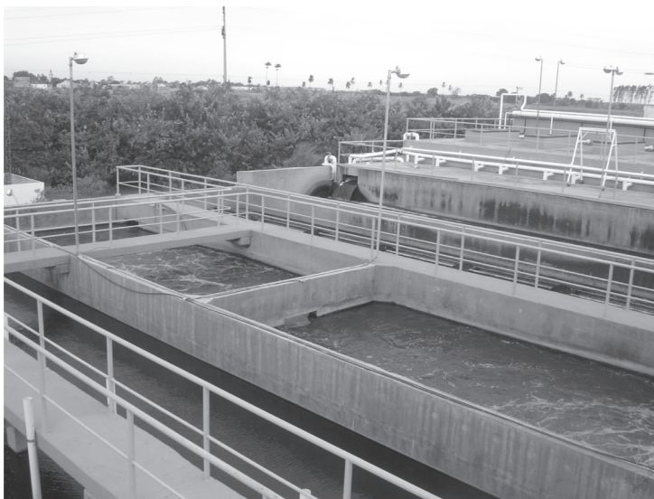
Figura 5: Complexo de tratamento de esgoto (sistema aeróbico e anaeróbico)
