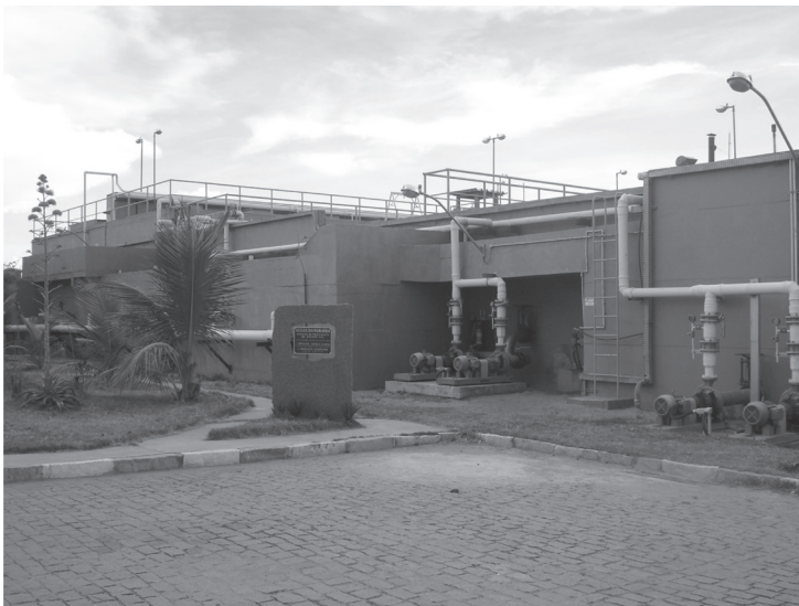
Figura 4: ETE da Chatuba
