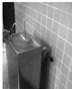
Figura 3: Jato de água na torneira de pressão do bebedouro do 1º pavimento do colégio.
