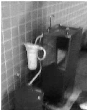
Figura 1: Mangueira de esgoto do bebedouro direcionada para galão de 20 litros.
