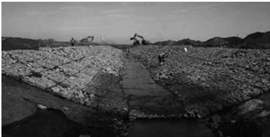
Figura 2 – Canal de drenagem: estaleiro da OSX
