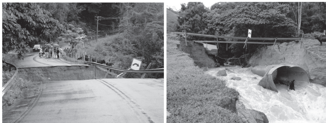
Figuras 9 e 10: Ponte na RJ 230 destruída por um deslizamento de terra, em dez/2013 Fonte: Jornal Dois Estados (2013)
