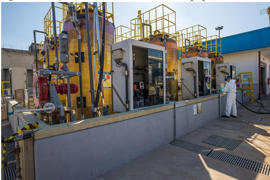
Figura 5 - Estação de tratamento de efluentes do Aquapolo.
