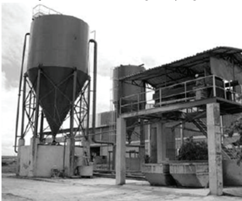
Figura 13- Decantador vertical acoplado ao filtro prensa
