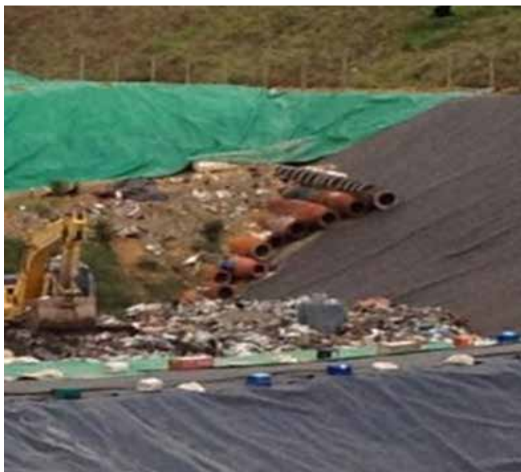
Figura 8: Floating Hoses dispostos em aterro industrial
