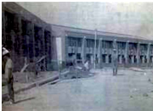
Ilustração 9 – Blocos em fase final de construção em Técnica em fase adiantada de construção.
