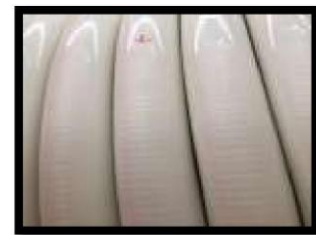
Figura 4 – Branqueamento ao longo do duto
