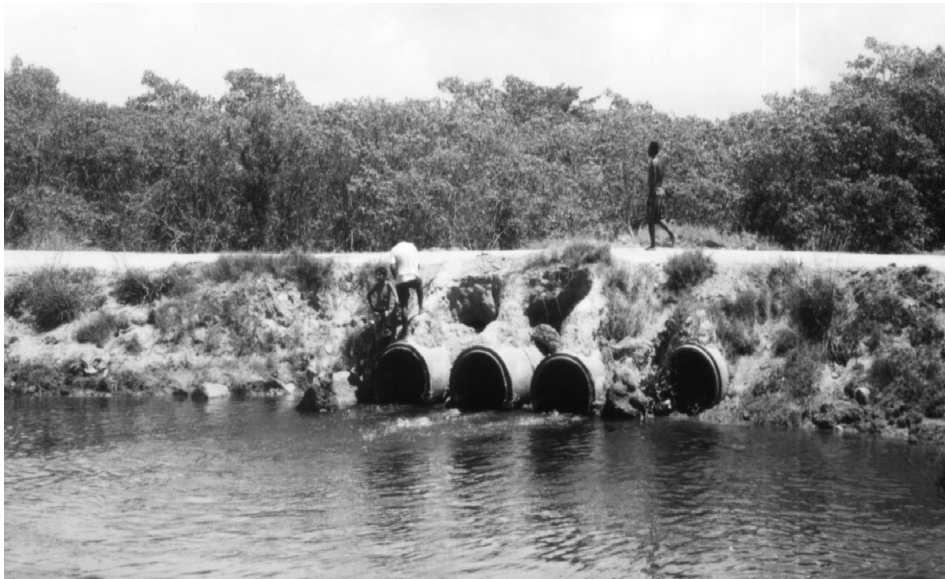
Figura 9: Manguezal do Córrego do Criador ou de Marobá. O barramento parcial do curso d'água pela rodovia ES-060 impede que as marés atinjam o manguezal à montante e afoga a rizosfera das plantas, submetendo-as a estresse.
