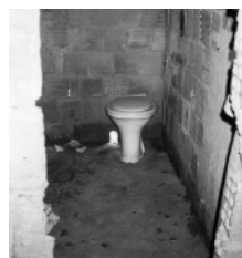
Vaso sanitário sem ligação com a rede de esgoto
