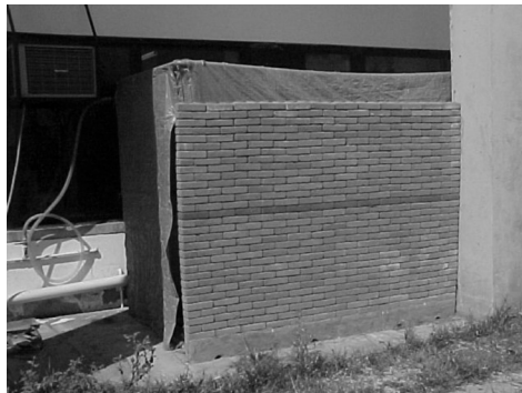
Figura 06: Câmara úmida - vista externa
