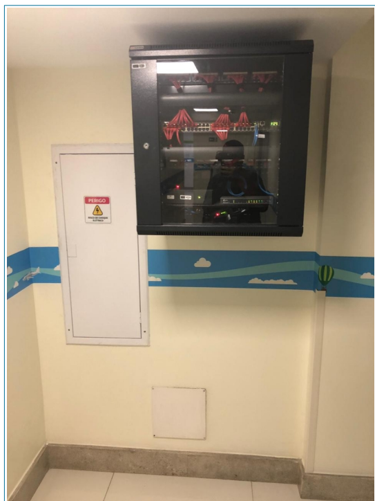
Figura 4. Rack de 12U do pavimento térreo
